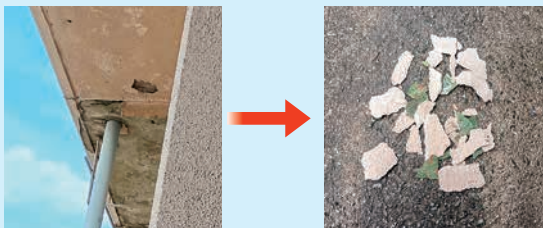
5階から落下し 砕けた破片
